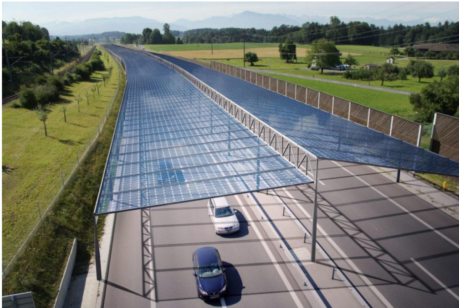
Instalación fotovoltaica sobre suelo construido
